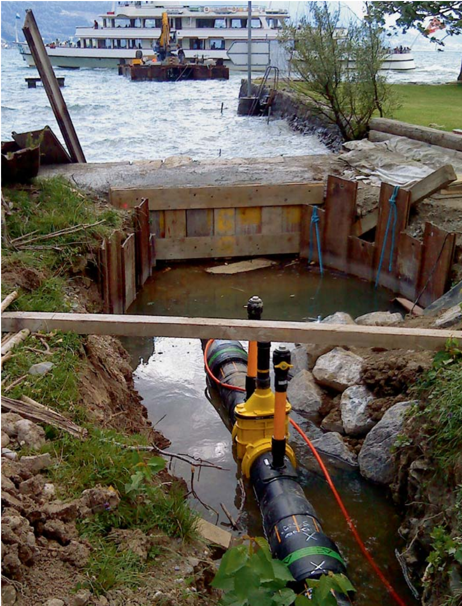
■ Einbindung einer Absperrarmatur am Übergang vom See zum Land.
