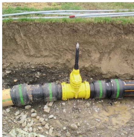
■ Eine mit FRIALEN-Sicherheitsfittings eingebundene Absperrarmatur.
