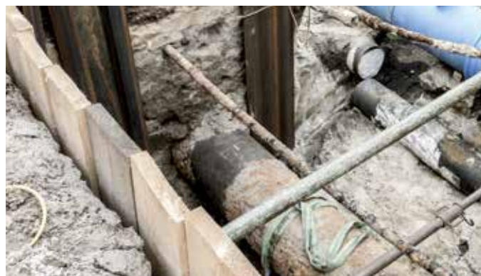
Paralleler Leitungsverlauf (alt & neu)
