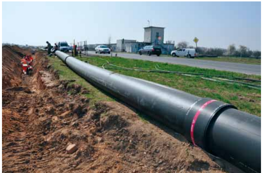
Die Verlegung erfolgte in offener Bauweise und verlief parallel der Bundesstraße B43.
