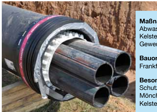
Schmutzwasserführende Rohre (d 180) im Schutzrohr
