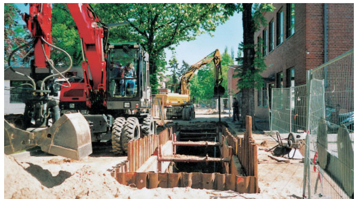
■ Die Dynamik im Erdreich nimmt zu.
