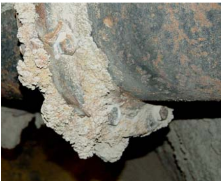
■ Undichte Flanschverbindung der Gussleitung.
