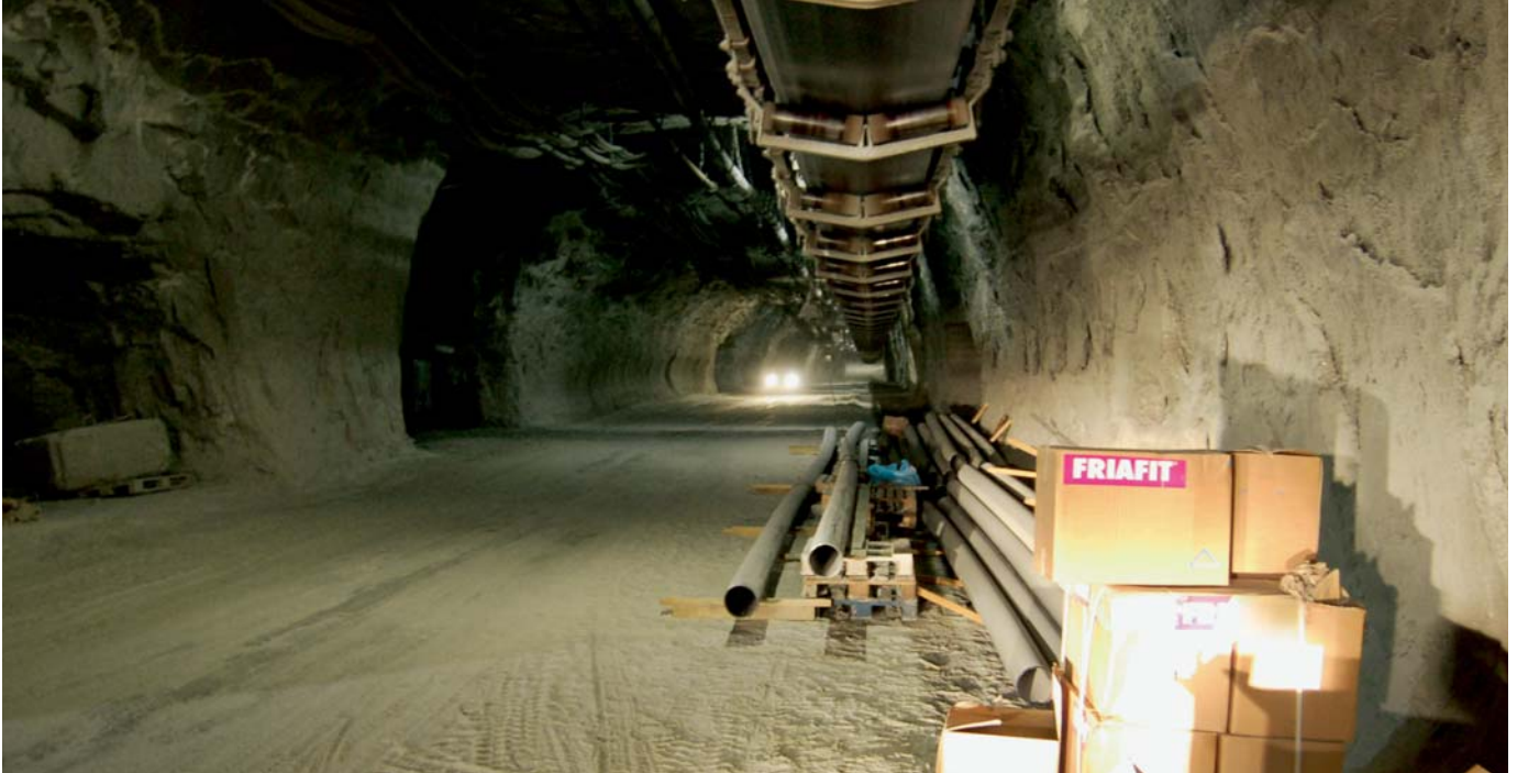
■ Die aggressive Sole wird in Rohrleitungen gesammelt und an die Oberfläche gepumpt.
