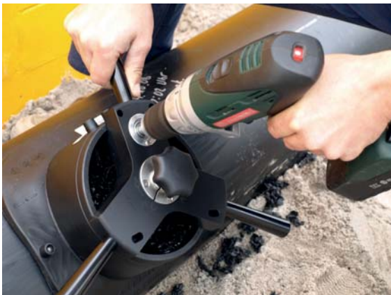
Abb. 3a: Anbohrvorgang mit FWFIT
