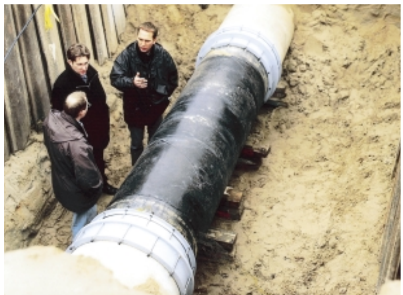
Bild 3: Reparatur einer Asbestzement-Rohrleitung DN 800, Ø 866 mm mit einem Stahlrohr DN 800, Ø 813 mm
