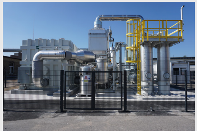
Bild 4: Ein Brennstoffzellenkraftwerk versorgt FRIATEC mit sauberer Wärme und Energie
