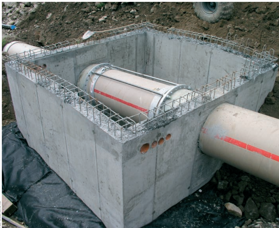
Bild 6: Ein- und Ausbaustück im Einstiegsschacht
