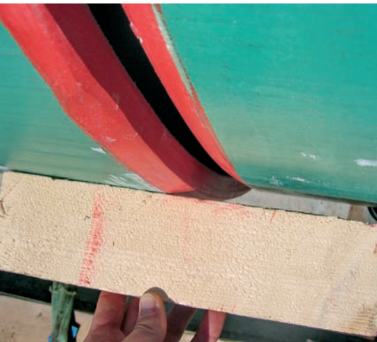
Bild 2: Achsversatz an einem GFK-Rohr DN 1600 Fig. 2: Axial misalignment of a DN1600 GRP pipe
