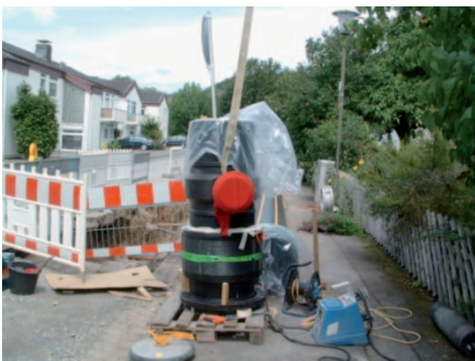
Bild 3: Verbund Rohr/Rohrbogen wird mittels FRIALEN-Muffe UB d 500 mm außerhalb des Grabens hergestellt
