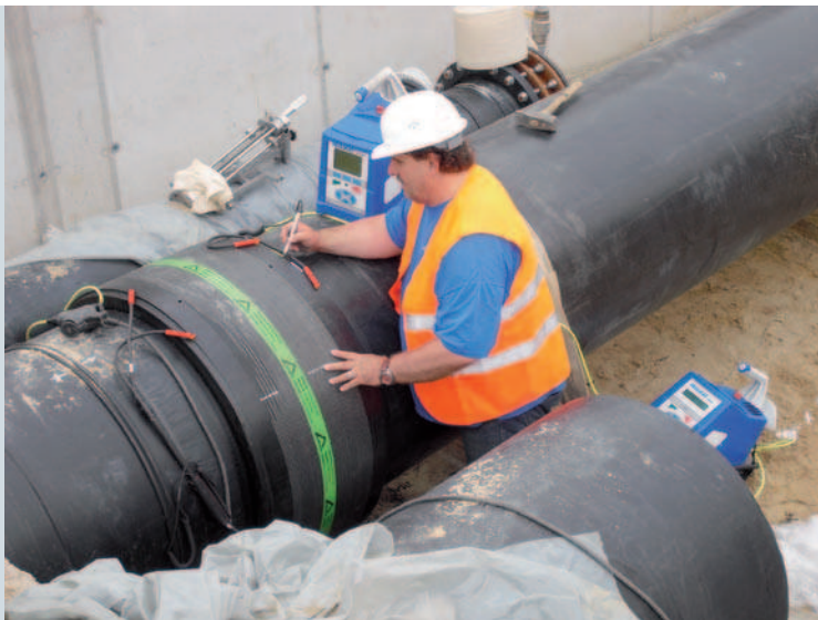
BILD 2: Die Fitting-Außenarmierung behindert dessen Ausdehnung während der Schweißung
