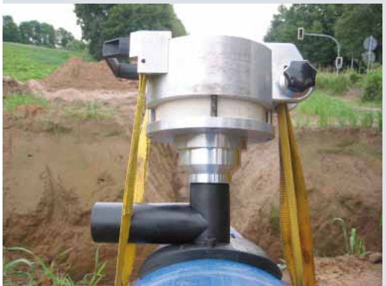
BILD 5: Hausanschluss durch eine Druckanbohrarmatur DAA an einer Trinkwasserleitung d 400 mm im Top-Loading-Verfahren
