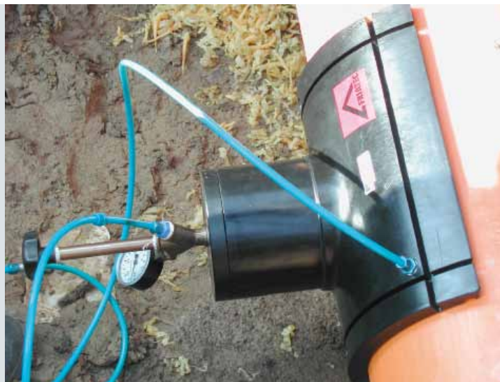
BILD 7: Erstellung eines Abzweigs auf einer Gasleitung d 315 mm unter Betriebsdruck mit dem FRIALEN XL Stutzensattel SA-XL
