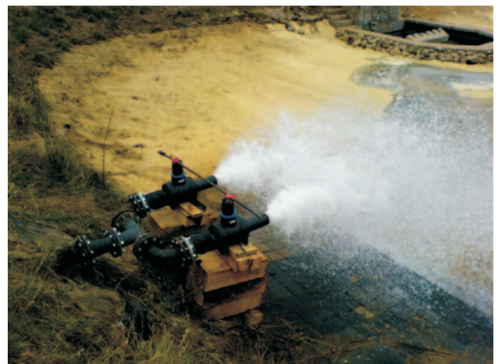
Bild 9: Freier Auslauf in Drosselstellung: Für die Armatur der Härtefall
