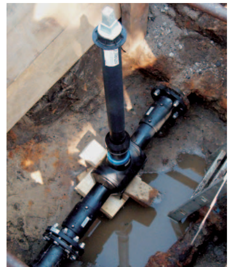
Bild 8: Einbindung in Gussleitung per Flansch zum Nachweis der Gebrauchstauglichkeit bei Mischverlegung PE/Guss
