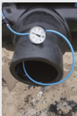
Bild 10: Überwachung der Absperrung mittels Manometer
