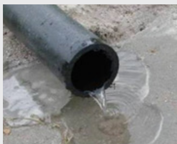
Bild 1: Nachlaufendes Wasser an der Reparaturstelle muss gestoppt werden
