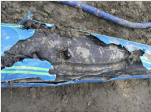
Bild 16: Durch Baggereingriff beschädigte Rohrwasserleitung
