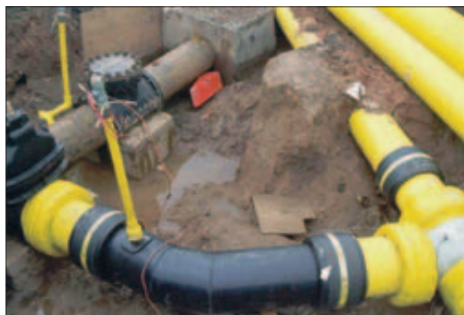
Bild 5: Einbindungen von Armaturen und Abzweigen in ein Gasleitungsnetz d 400 mm bis d 630 mm zur Befüllung des Gaskessels
