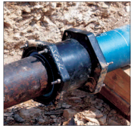
Bild 1: Werkstoffübergang von Stahl- auf GGG-Leitung mit FRAGRIP®-Kupplung DN 250
