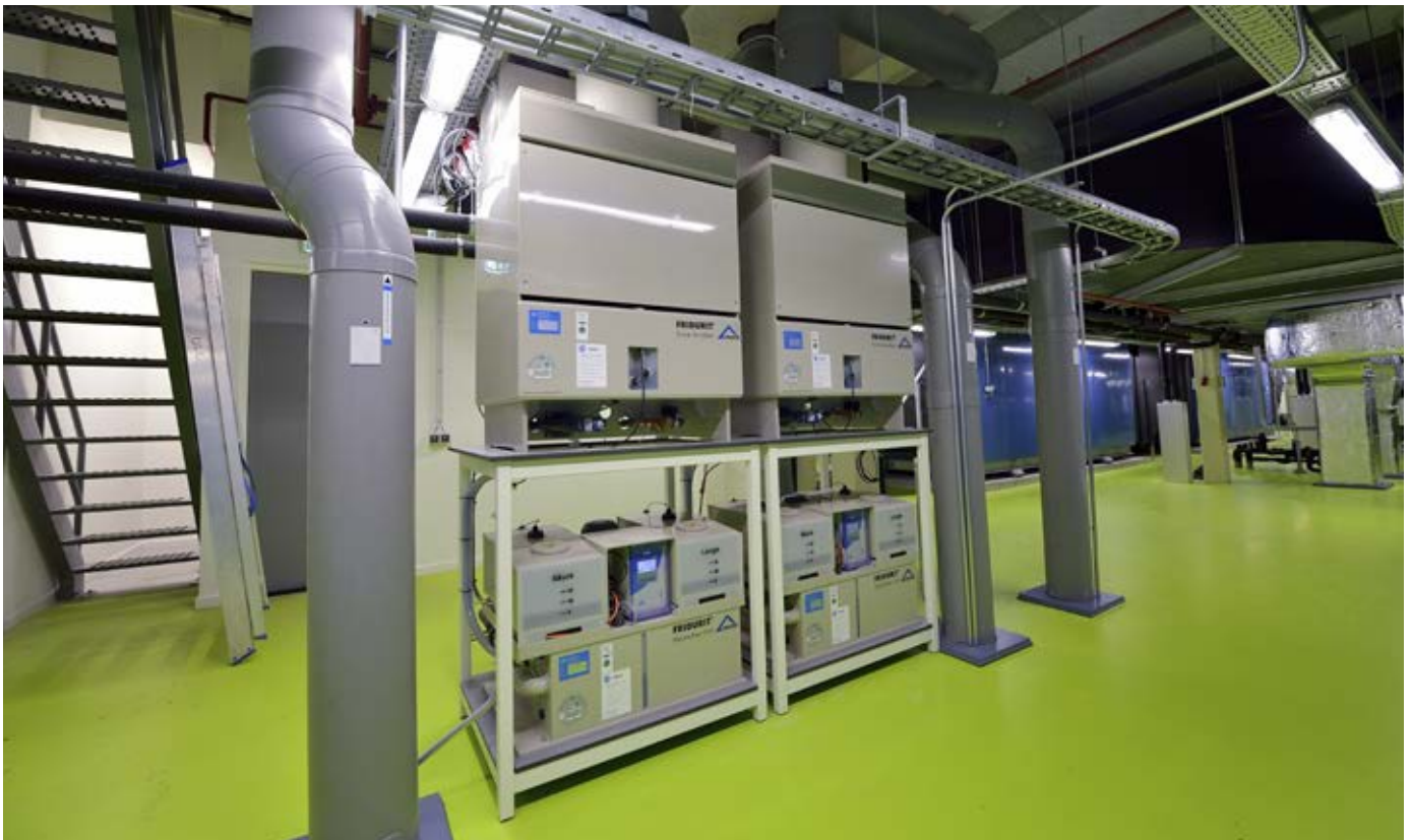
FRIDURIT Abluftwäscher C180 mit FRIDURIT Neutralisationsanlage zur Behandlung des chemisch belasteten Abwassers aus dem Abluftwäscher.
